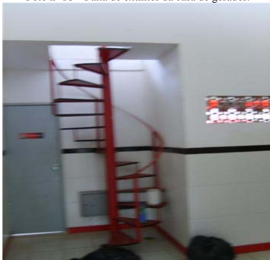
Foto n.º 17: Escada de acesso à varanda da imprensa sem guarda corpo na parte superior, não atendendo às normas de acessibilidade.
