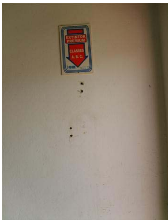
Foto n° 16 – Falta de extintor da casa de gerador.
