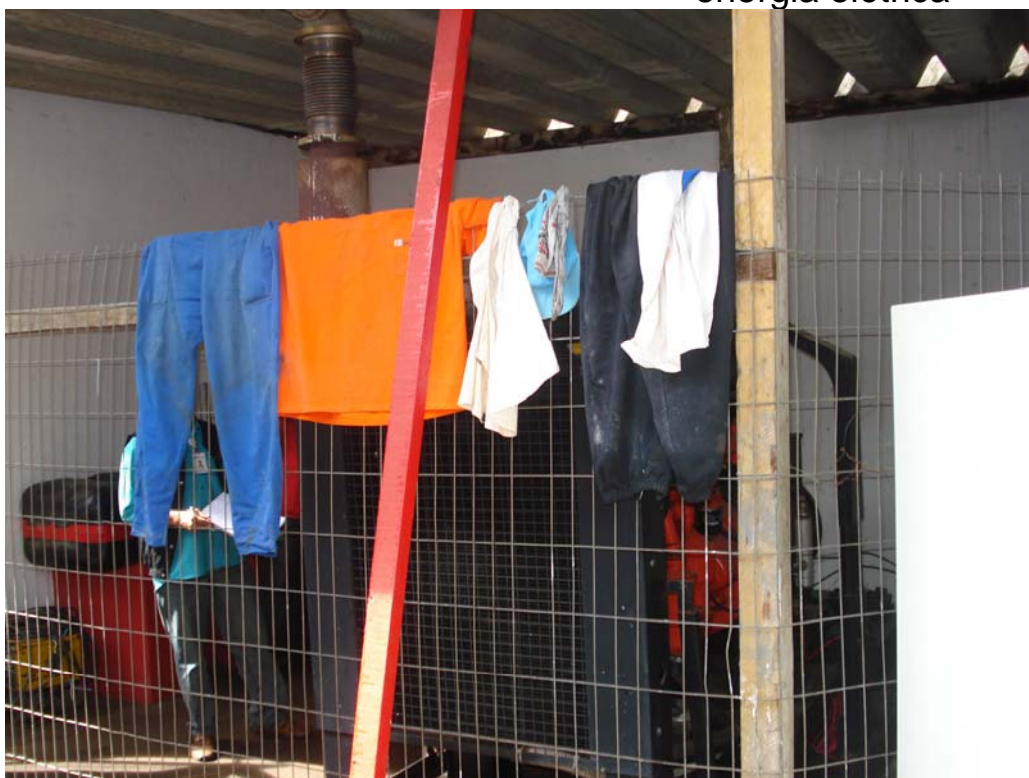
Foto n 15 - Grupo Gerador de energia elétrica
