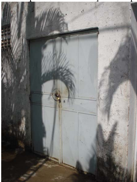
Fotos n. os 11 –Porta de acesso a subestação.
