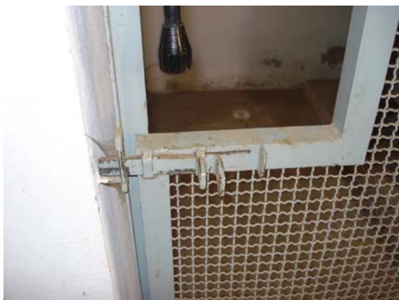
Foto nº 13 – Grade de proteção de cubículo elétrico.
