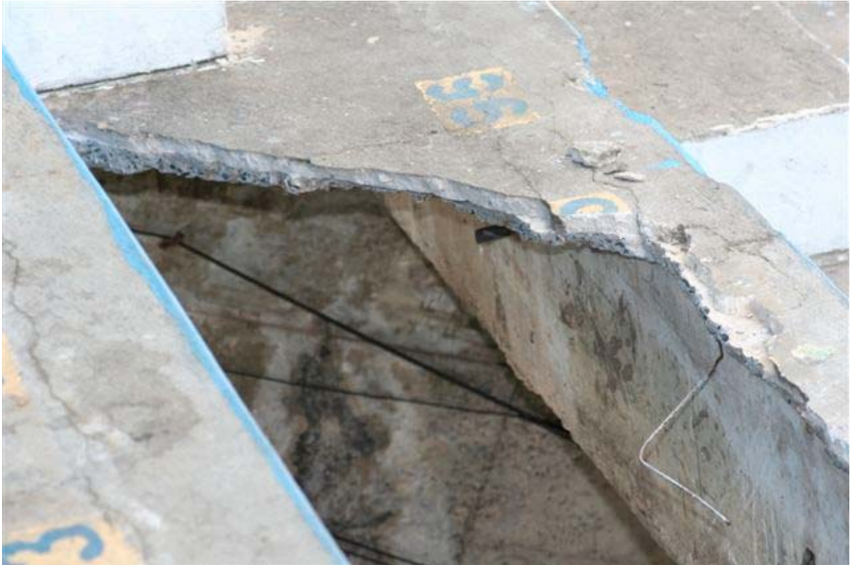
Foto 05 – Detalhe da ferragem da laje rompida.
