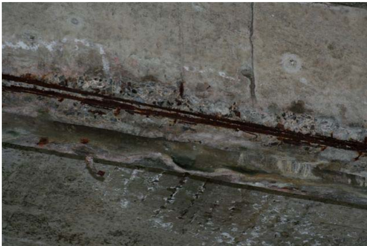
Foto 10 – Vista inferior de viga com ferragem exposta no anel superior.
