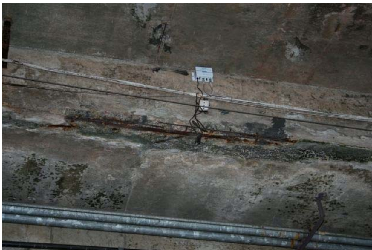
Foto 15 – Detalhe de incidência de umidade e fiação elétrica exposta.
