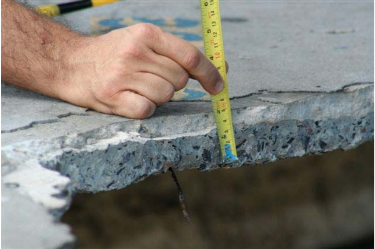
Foto 07. – Vista da espessura da laje rompida.
