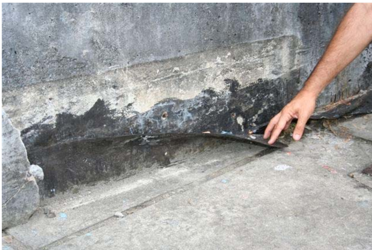
Foto 17 – Detalhe da manta de impermeabilização danificada.
