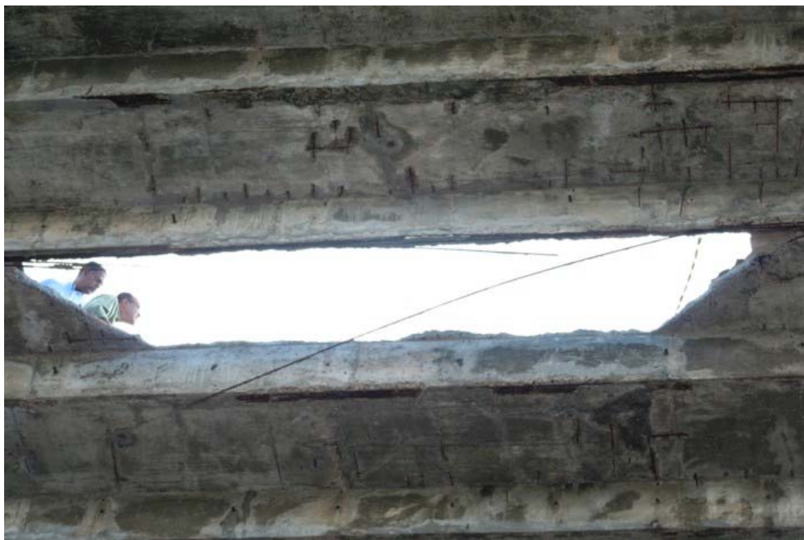
Foto 03 – Vista inferior da área onde ocorreu o sinistro.
